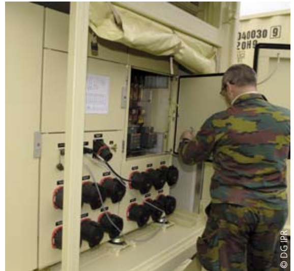
Foto 8: Voor de semi-permanente kampen in desolaat gebied is het belangrijk om zelf in de elektriciteitsproductie te voorzien.
